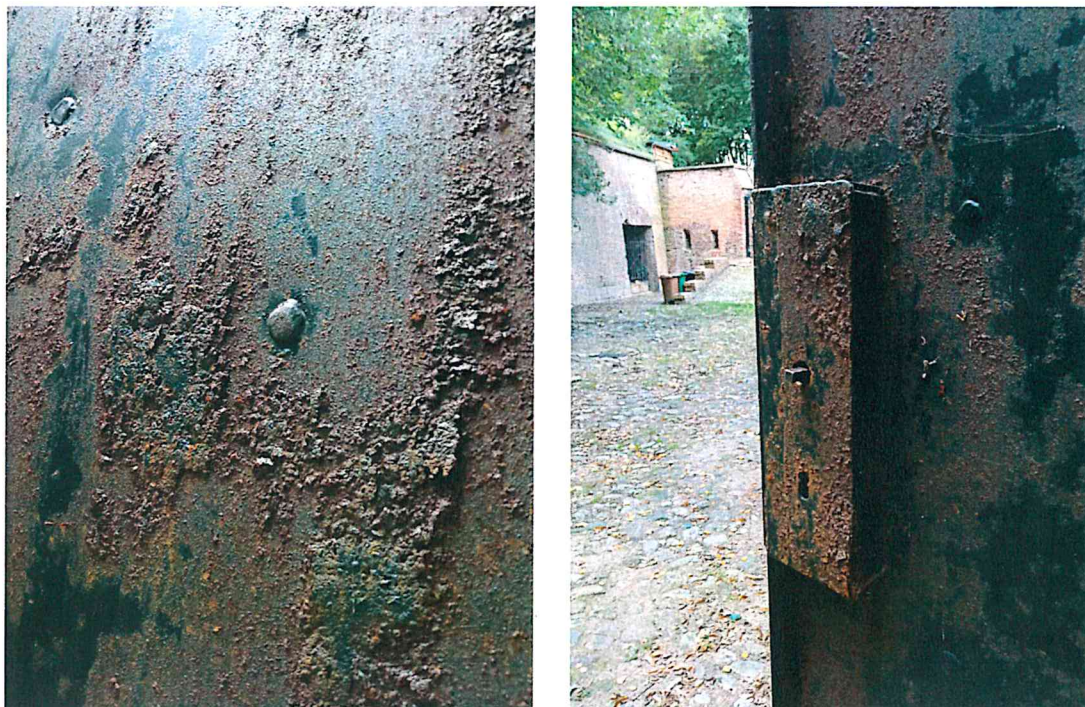
Fot. 3.,4. Spilowane śruby od wnętrza bramy 1, zamek
