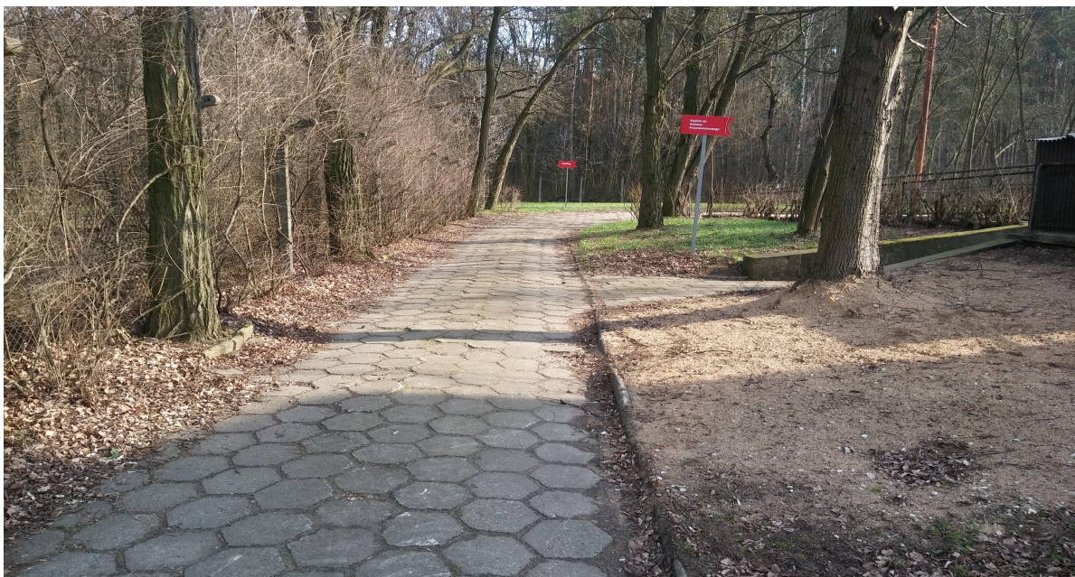
Fot.3 – Uszkodzony opornik betonowy, nawierzchnia z trylinki oraz płyt 30x30cm
