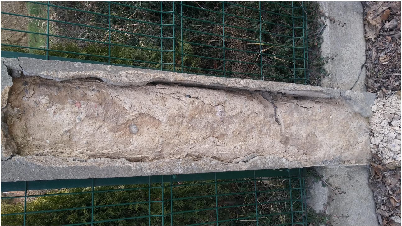
Fot. 5- Uszkodzony słup ogrodzeniowy
